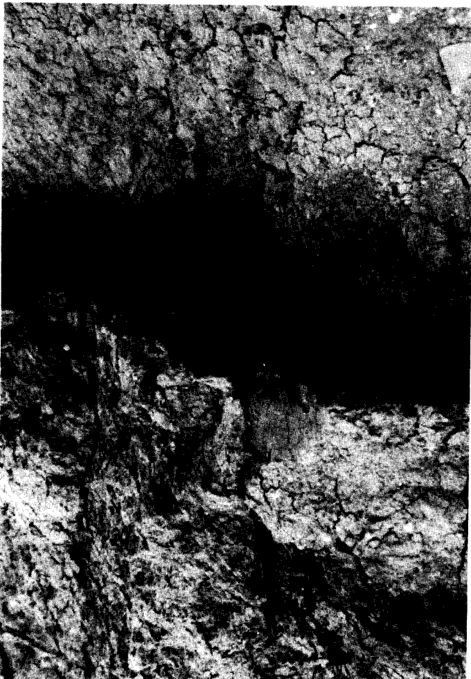
Fig. 5. La capa de marga se desliza sobresaliendo unos 35 cm sobre una de lutita (diciembre de 1991), en la margen derecha del arroyo Tlaxómotl.
