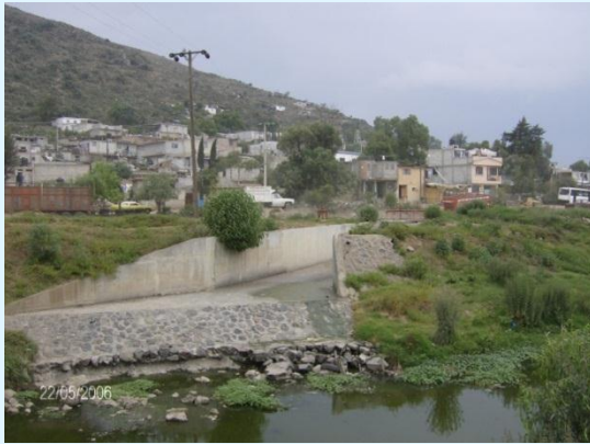
Salida de Aguas residuales de la ciudad de Tulancingo, Hidalgo
