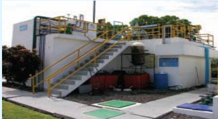
Tanque de regulación
