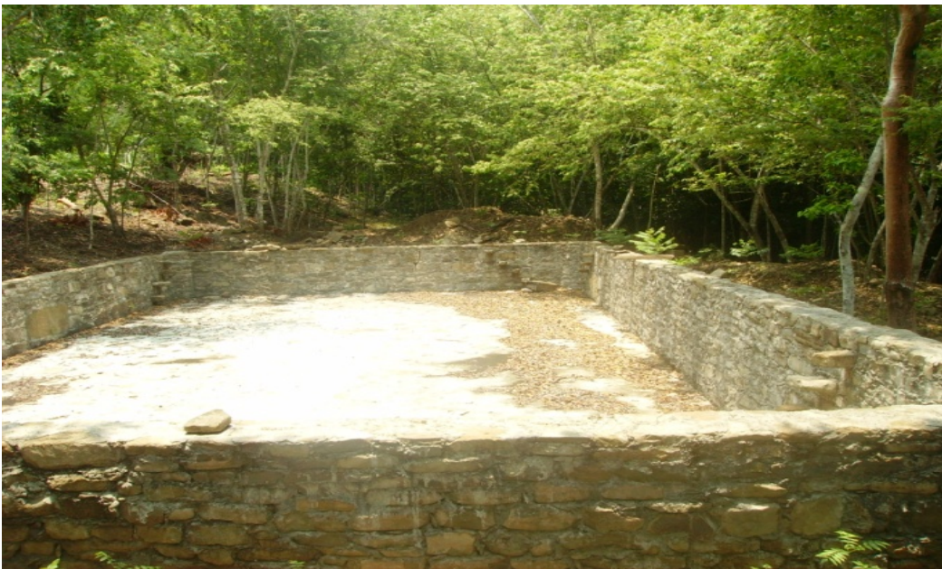
Figura 2.- Estanque Piscícola medidas 10x17m
